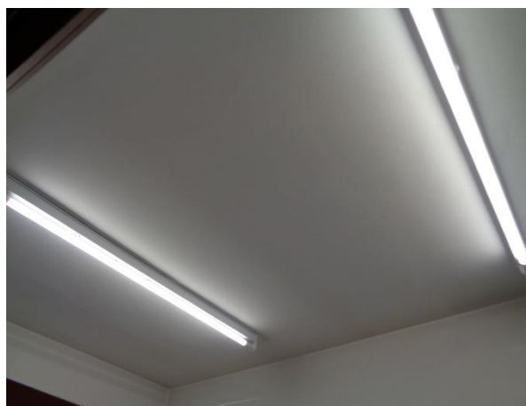
Figura 4.15 - Particolare dei corpi illuminanti a led 1x18 locale Disimpegno
