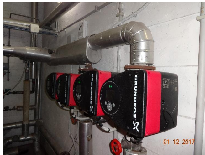
Figura 4.7 - Particolare della pompa di circolazione, valvola a 3 vie e lettura di temperatura
