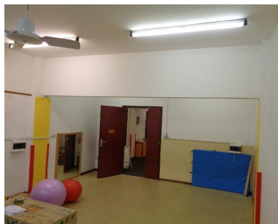
Figura 4.14 - Particolare dei corpi illuminanti ubicati nelle aule
