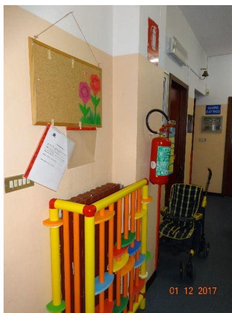
Figura 4.6 - Particolare installazione radiatori
